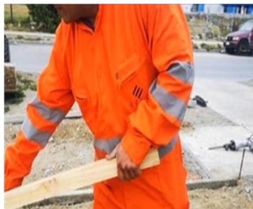
Se observa tablón retirado desde el camión, movimientos de flexion y extensión de codo derecho, agarre con fuerza de ambas manos. Sin uso de guantes.
