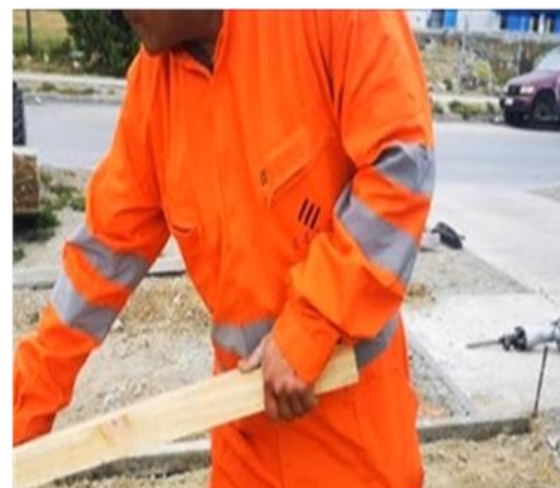
Se observa tablón retirado desde el camión, movimientos de flexión de codos, agarre con fuerza de ambas manos. Sin uso de guantes.
