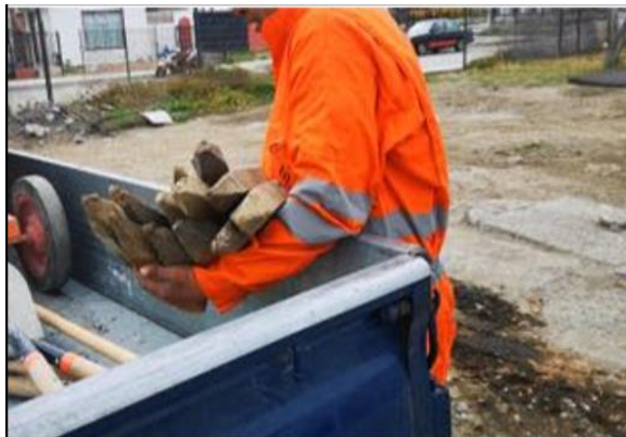
Se observa la carga de estacas de madera, con flexión de ambos codos en 90° durante el transporte desde el camión hasta el lugar de acopio. Sin uso de guantes.
